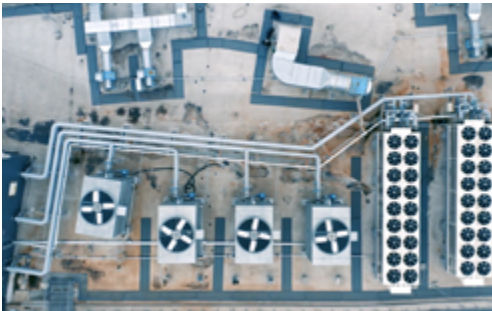
Vista aérea de sistemas de aquecimento, ventilação e ar-condicionado instalados na cobertura.
